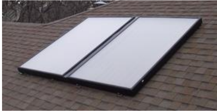
Dos colectores solares planos instalados en un tejado
